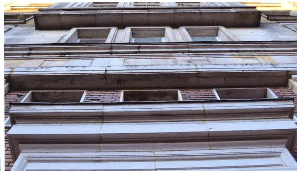
II. 50 Kamienne opracowanie elewacji frontowej w osi wykusza, od dołu widoczny portal, trzecia kondygnacja, podniebienie wykusza
