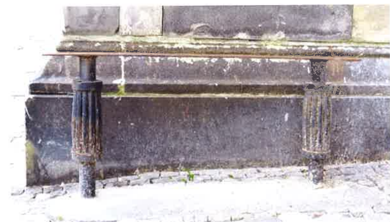
II. 114 pozostałość oryginalnej ławki przy elewacji między głównym korpusem a północnym łącznikiem
