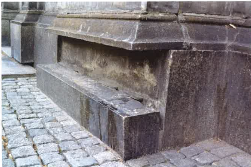
Il. 54 Cokół elewacji frontowej z granitu – ubytek jednej z płyt okładziny
