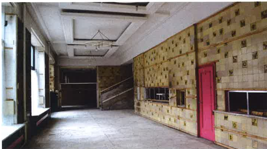
II. 79 Wnętrze d. baru mlecznego „Złota Kurka”, (dokumentacja w karcie Lokal użytkowy, d. bar mleczny, „Złota Kurka”, budynek 1B MDM, ul. Marszałkowska 55/73 )
