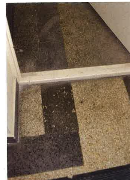
II. 97 Posadzka między parterem a piwnicą
