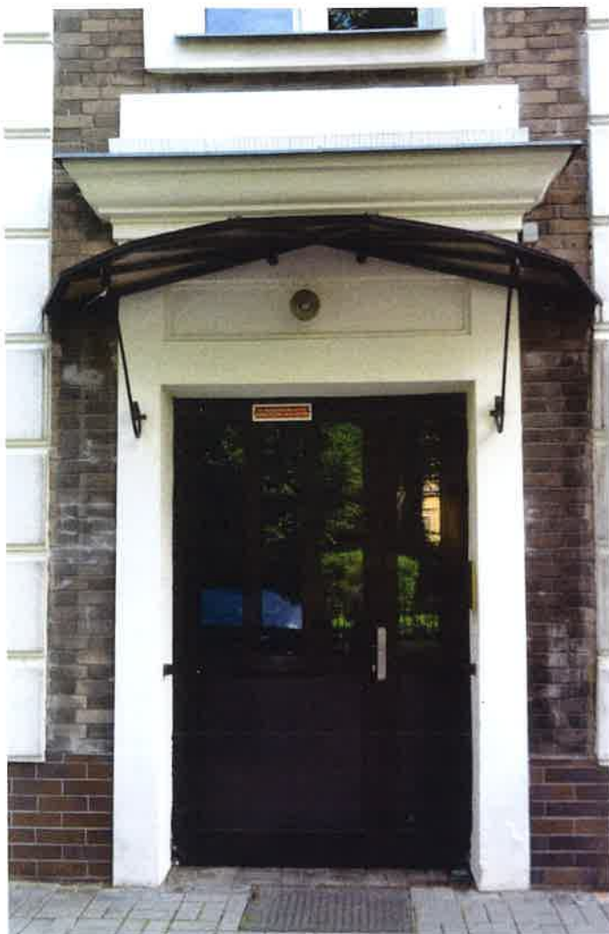
II. 60 Wtórne drzwi z PCW na klatkę schodową z ahistorycznym zadaszeniem
