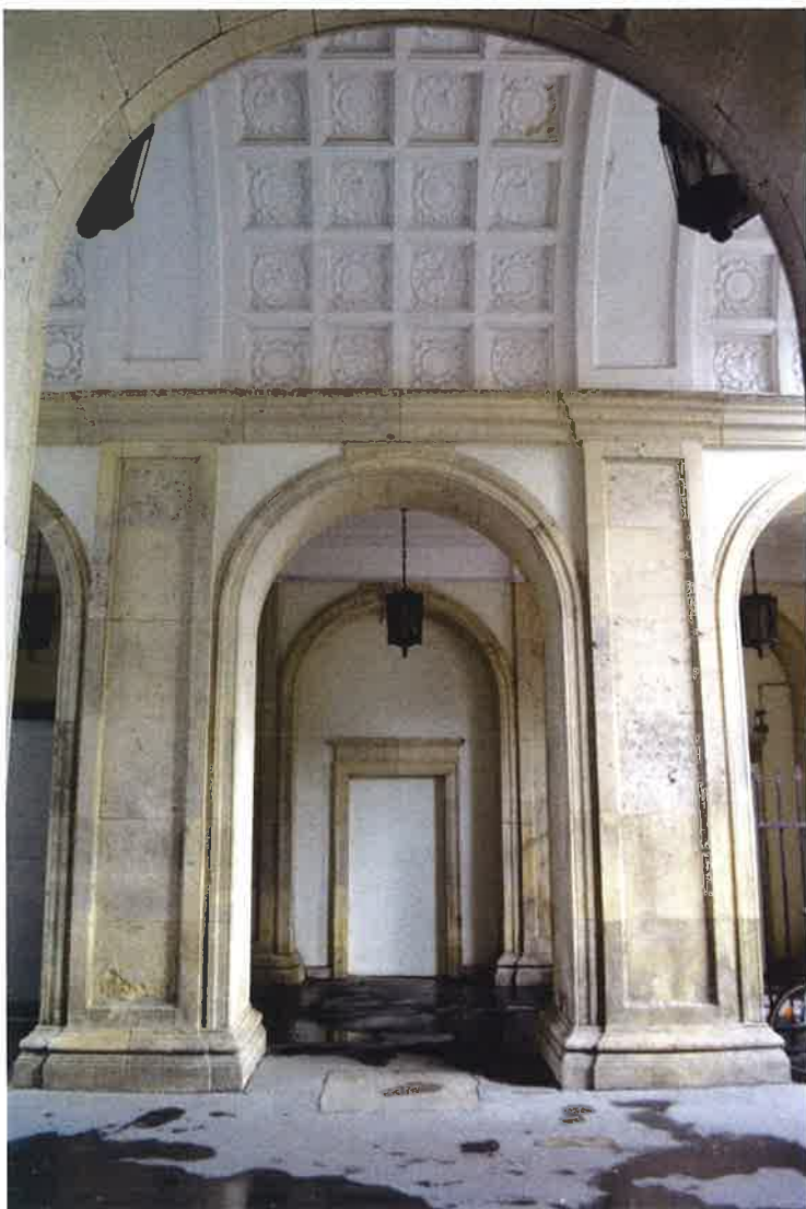
II. 71 Łącznik południowy widok południowej nawy środkowego przęsła na ścianę północną, na wprost filary, w bocznych nawach po 3 latarnie (po jednej na środku przęsła), asfaltowy przejazd
