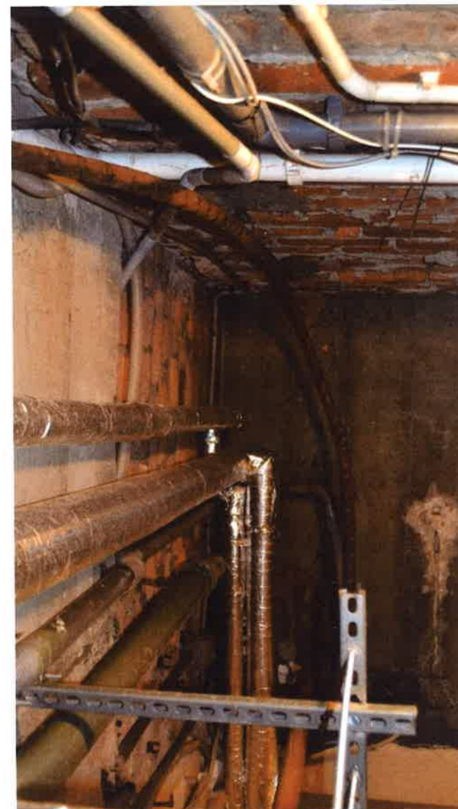
II. 103 Instalacje prowadzone podsufitowo w korytarzu piwnicznym
